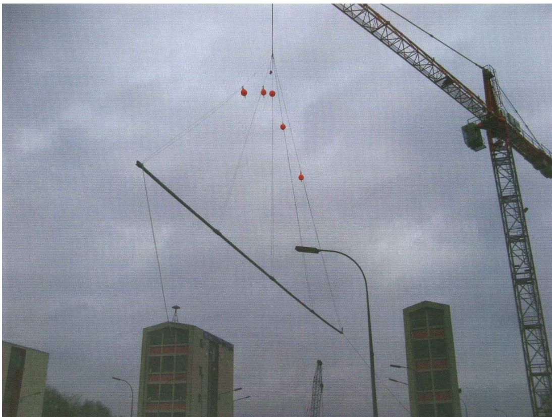
Mobile Luftsprudelanlage Schleuse Geesthacht
