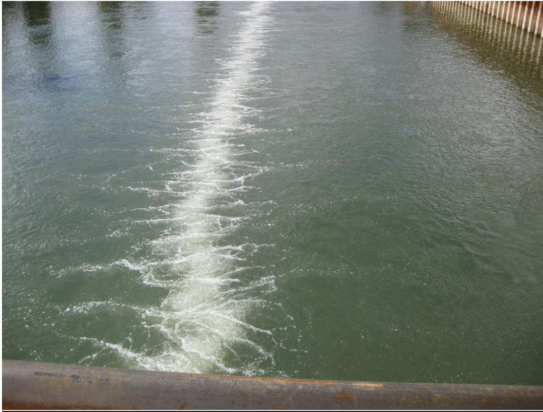
Druckluft-Ölsperre im Tanklager BP/TanQuid Mainz-Gustavsburg
