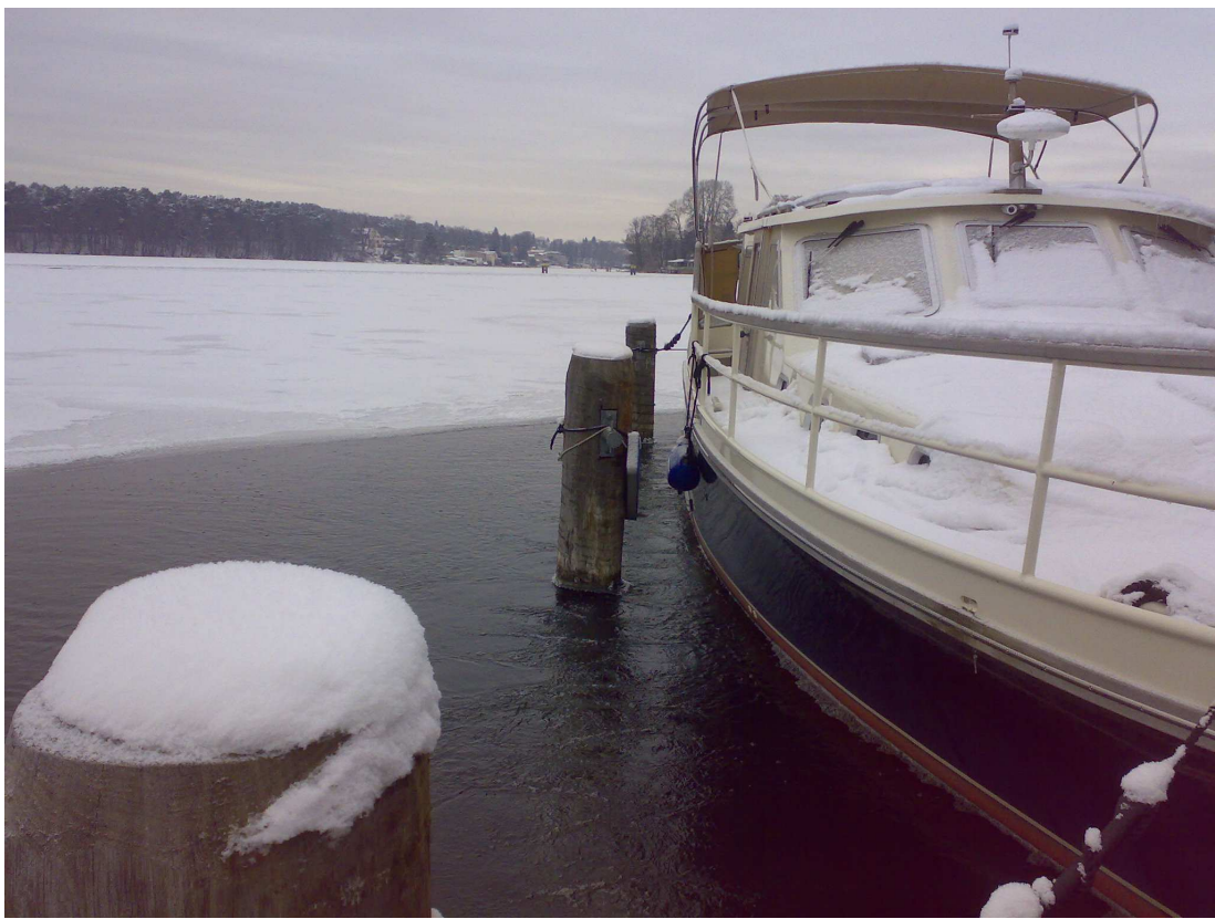
Eisfreihaltesystem für Bootssteganlage Wilhelmsbad
